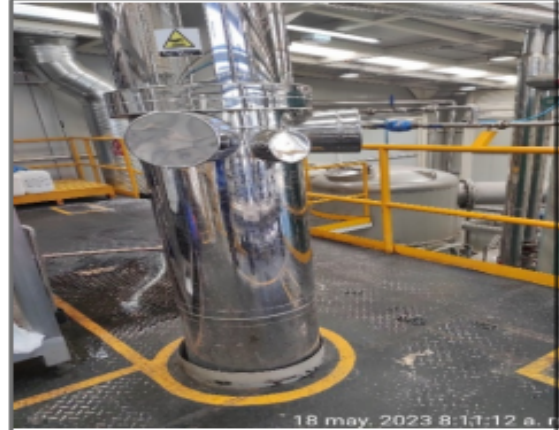
Fotografía 6. Puertos y plataforma de muestreo Caldera Colmesa
