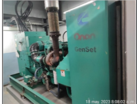
Fotografía 8. Planta eléctrica No. 1 de 600 kVA
