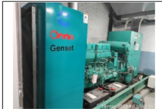
Fotografía 9. Planta eléctrica No. 2 de 600 kVA
